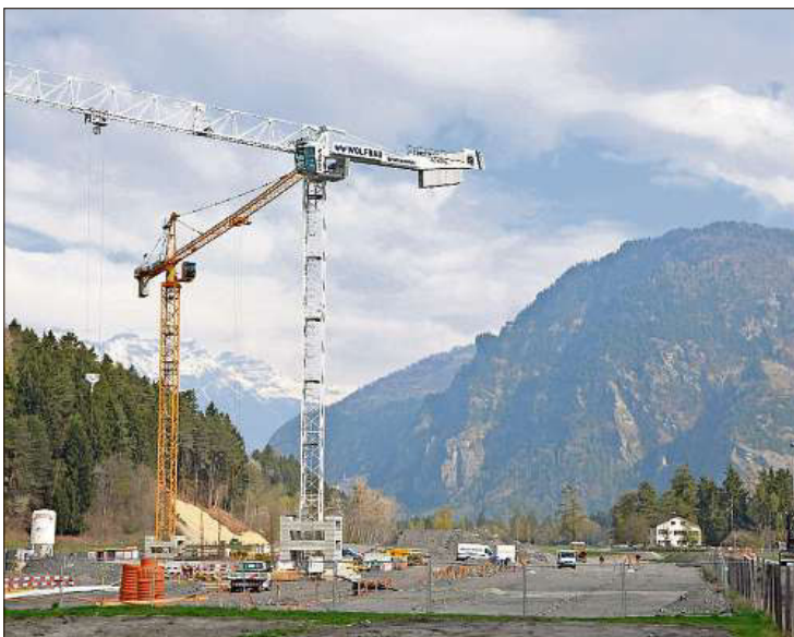
Hier werden die neuen Gebäude der geschlossenen JVA Realta zu stehen kommen.
